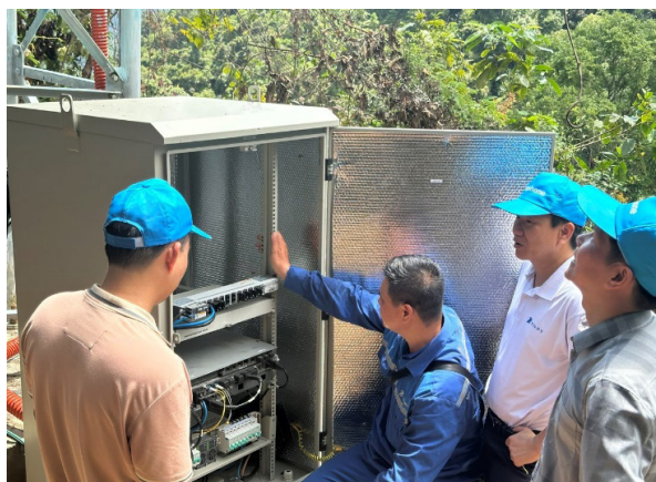
Đồng chí Phạm Quang Cường - Phó Giám đốc Sở KH&CN kiểm tra trạm BTS do VNPT Lai châu xây dựng tại bản Thà Giàng Phǝ xã Tủa Sín Chải
